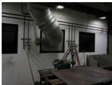
Figura 3B: Tubulação do Sistema de exaustão do Lab. PRUS III
