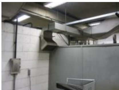
Figura 2: Sistema de ventilação mecânica do Laboratório PRUS II
