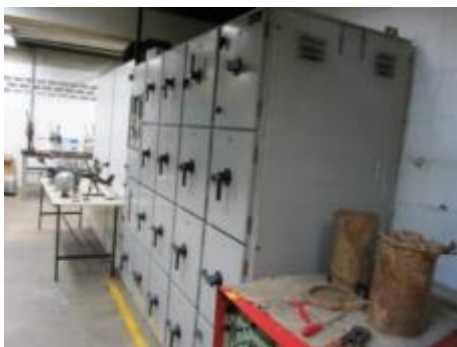
Figura 5: Painel Elétrico do Laboratório PRUS II.
