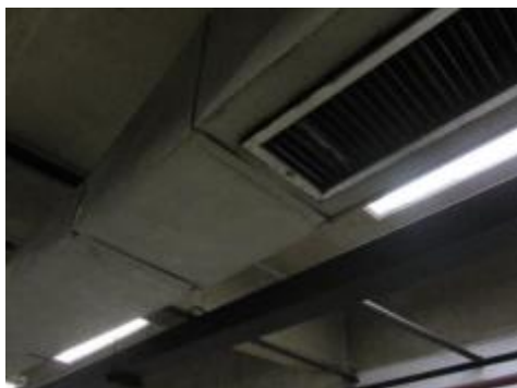
Figura 3A: Sistema de exaustão do Laboratório PRUS I e II.
