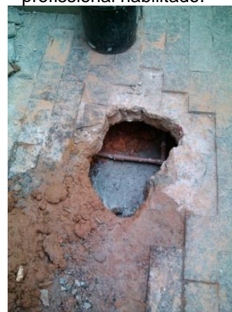
Figura 1. Vazamento identificado na entrada do edifício e corrigido por profissional habilitado.
