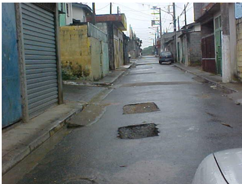
Foto 01 – Exemplo de Recorrência de Vazamentos (Fonte: Sabesp-MNEP/08)
