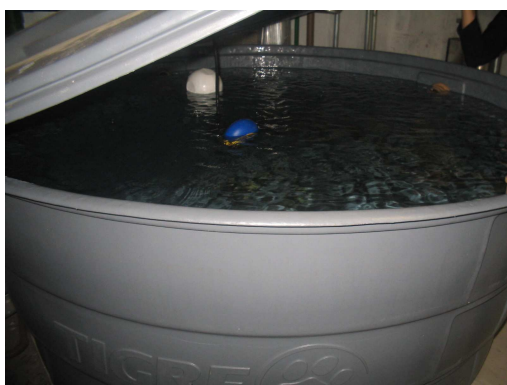
Figura 3: Caixa d'água de 500L para armazenamento do rejeito do primeiro passo da
