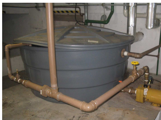
Figura 4: Caixa d'água, sistema de tubulação em PVC e bomba hidráulica do sistema de reuso de água
