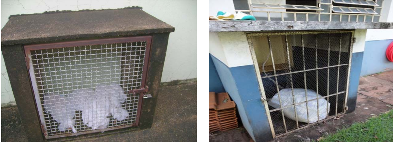
Figura 6 – “Caselas” de armazenamento temporário de RSS de consultórios odontológicos, sem identificação do tipo de material que é armazenado. Os sacos de lixo também não contêm identificação de risco.
