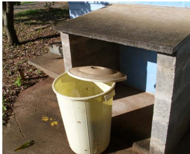
Figura 14 – “Casela” de armazenamento temporário externo para RSS sem proteção e sem identificação de risco.
