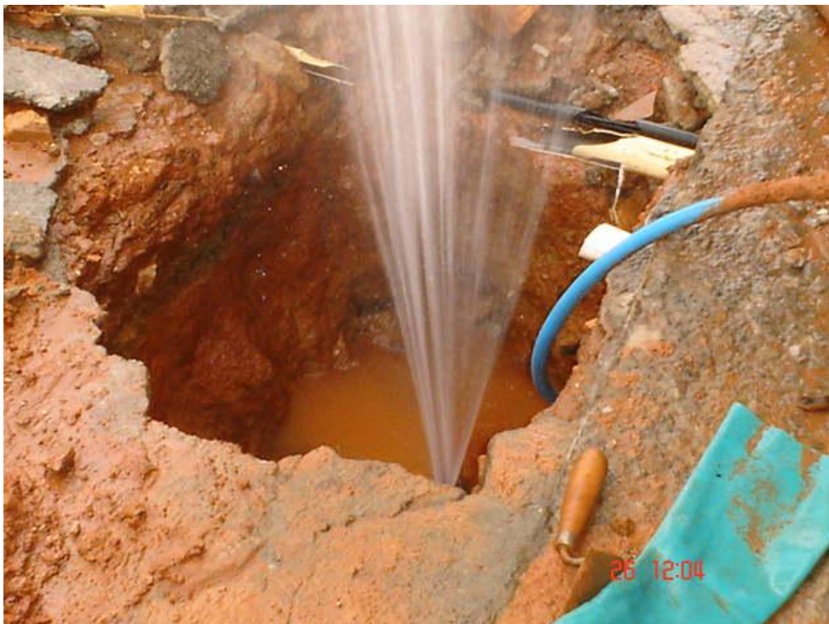
Figura 5 - Exemplos de vazamentos que ocorrem nas ligações domiciliares
