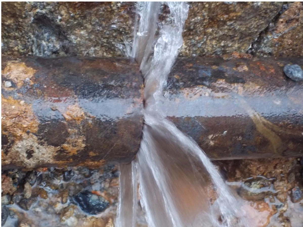
Figura 6 - Exemplos de vazamentos que ocorrem em redes de distribuição
