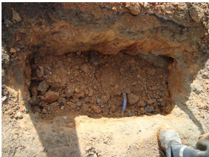
Figura 46 - Recobrimento inadequado do ramal de conexão de água.
