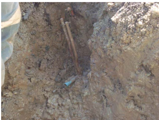
Figura 45 - utilização de ferramenta inadequada para estancar o fluxo de água.
